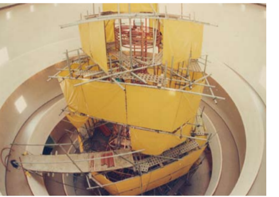
(위)1968년 초 진행된 다다이선 건설 공사. 국립현대미술관 미술연구센터 소장, (아래) 2022년 초 다다이선 시공기 중 당시의 모습. 국립현대미술관 제공.
